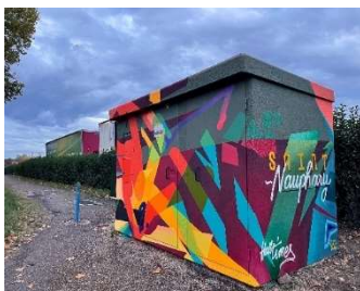
Nouveau look pour le transformateur EDF ZA Simarre
