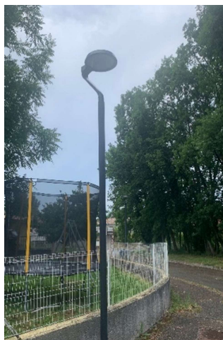
Nouvel éclairage LED impasse des Noyers
